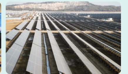
새만금 육상태양광 발전단지 현장
